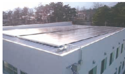
環境に配慮し屋上に太陽光パネルを設置 (325㎡、55,000kwh/年)
